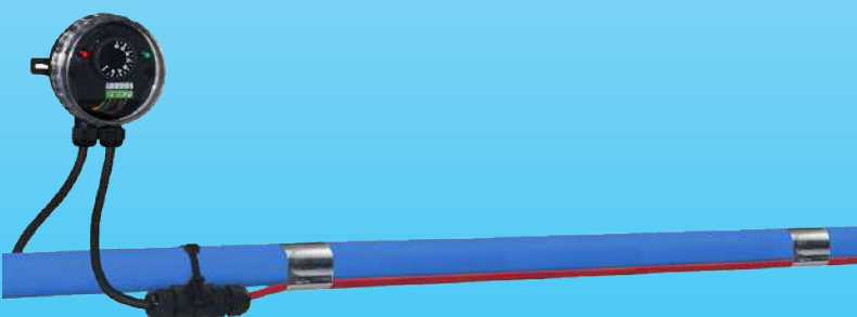
Пример монтажа на одном кабеле теплофикации, с соединительной коробкой Y24, для защиты от замерзания труб PVC
