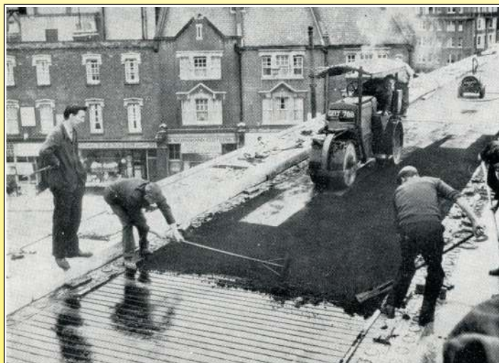
1969 Укладка асфальта на верхнюю проезжую часть развязки Хаммершмидта в Лондоне (Электрический подогрев проезжей части, Роберт Феликс, 1971 г., Музей Ultiheat*)
